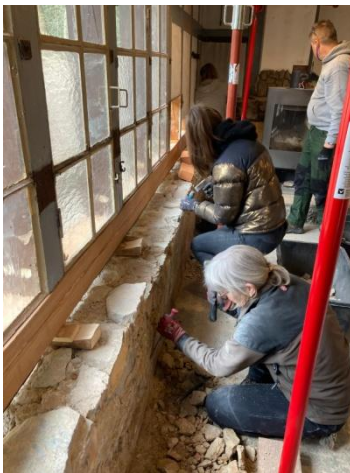
Abb. 20: Der alte, verfaulte Trägerbalken ist entfernt und der neue Lärchenbalken ist eingesetzt. Hier wird der Balken mühevoll untermauert und das Sockel-Mauerwerk wird gesäubert.
