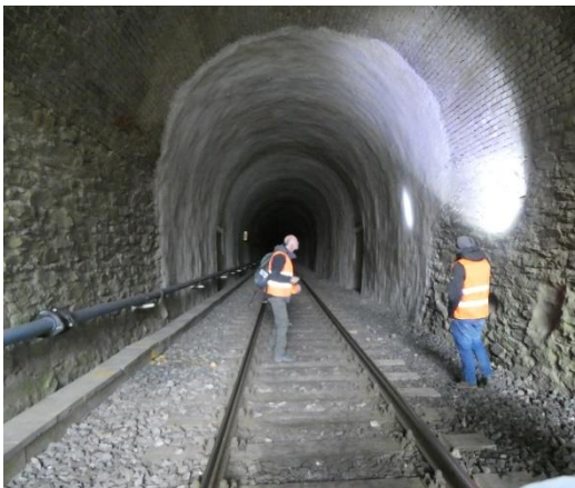
Abb. 15: Der Grävenwiesbacher Eisenbahntunnel ist seit 2001 wieder für den Zugverkehr geöffnet. Dieser und bauliche Maßnahmen, wie die Zerstörung der Fledermausquartiere durch Verputzen der Wände und Decken mit Spritzbeton (hinterer Bereich) haben das Quartier endgültig unbrauchbar gemacht.
